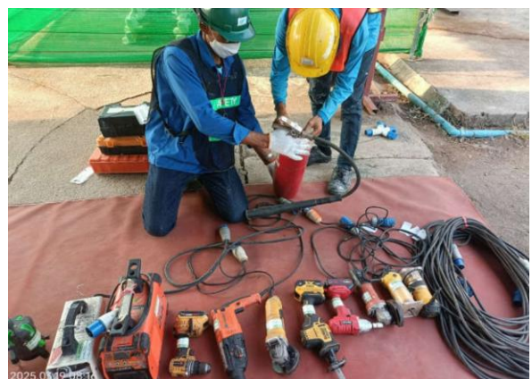
ตรวจเช็คอุปกรณ์ไฟฟ้าก่อนเริ่มงานและทุกเดือน
